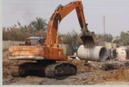
۴ کلومیٹر طویل LDA کی بیرونی سیوریج لائنوں کا کام تقریباً مکمل ہو چکا ہے
